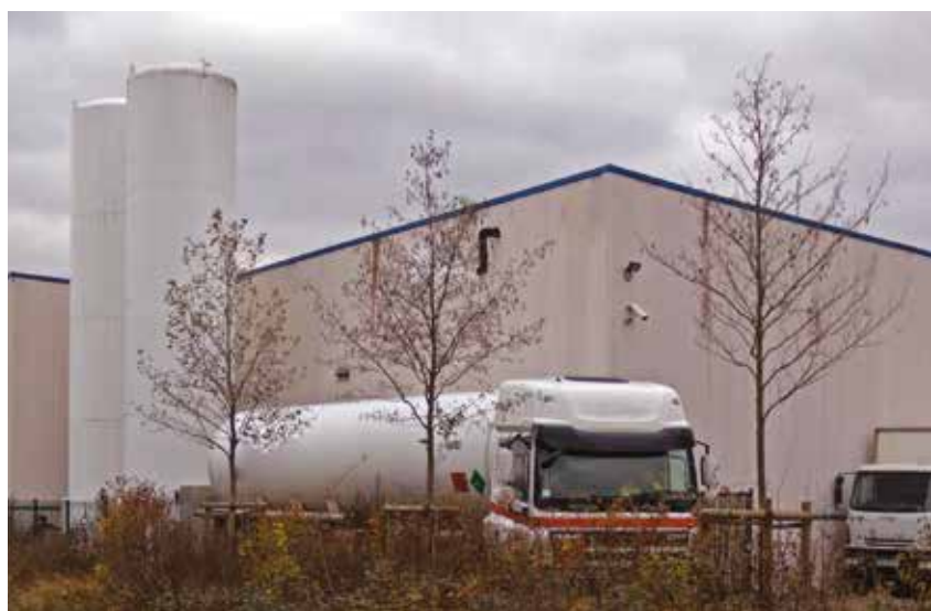
Les deux cuves d'une capacité de stockage de 30 tonnes chacune de CO 2 liquide.
