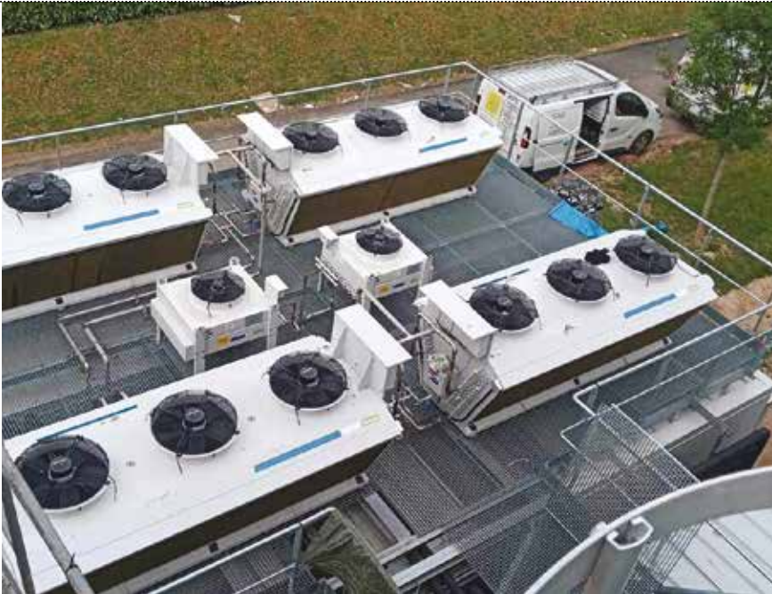
Vue en plongée du local technique.
